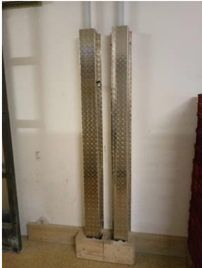
Bild 3: Verkofferung der Sammelleitung mit Riffelblech-Rammschutz und Sockelrammschutz mit Holz
