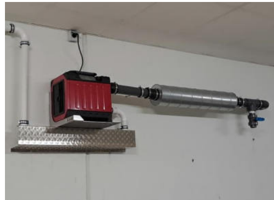
Bild 2: Radonsauger auf Konsole mit Schalldämpfer und Kondensatabscheider in der Fortluft und Rammschutz mittels Riffelblech-Verkofferung
